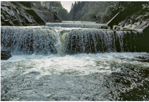
Abbildung 1.8: Querverbauungen in Fließgewässern als Hindernisse für Wanderbewegung von Wasserorganismen.
