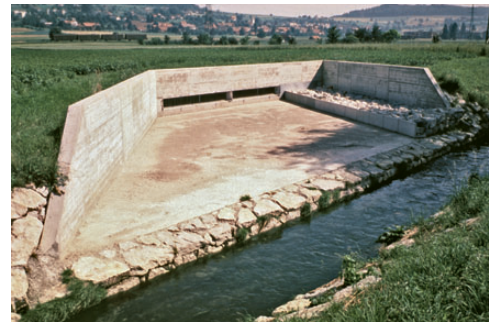
Abbildung 3.16: Mischwasserentlastung im Furtal/ZH. (Foto: AWEL, Zürich)
